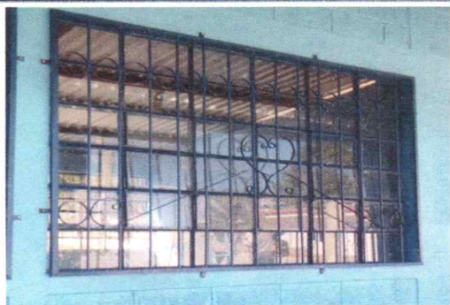
Foto 5: Ventanas con balcones instalados
