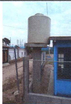
Foto 6: Depósito de agua instalado
